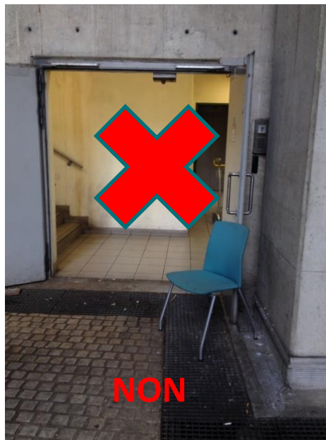
Accès non sécurisé à une zone de réserves
